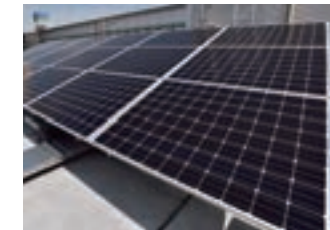
太陽光発電・屋上緑化等 環境配慮型店舗を順次設置
